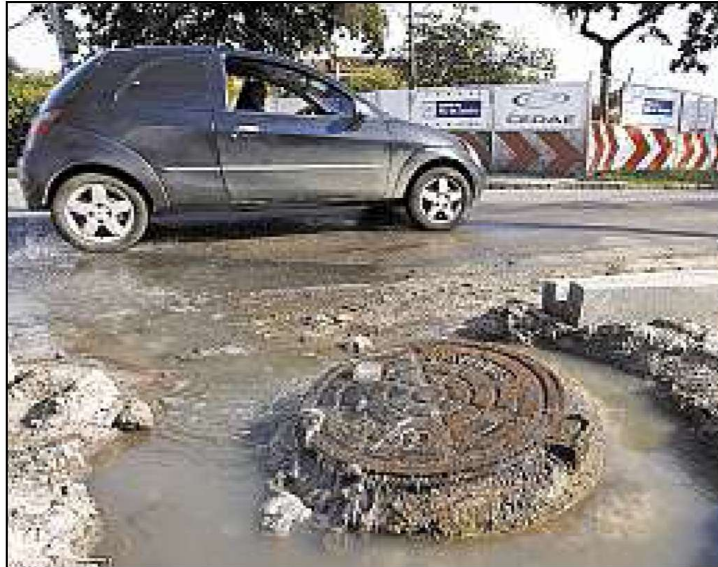
■ VAZAMENTO NA Avenida Gilka Machado, no Recreio
